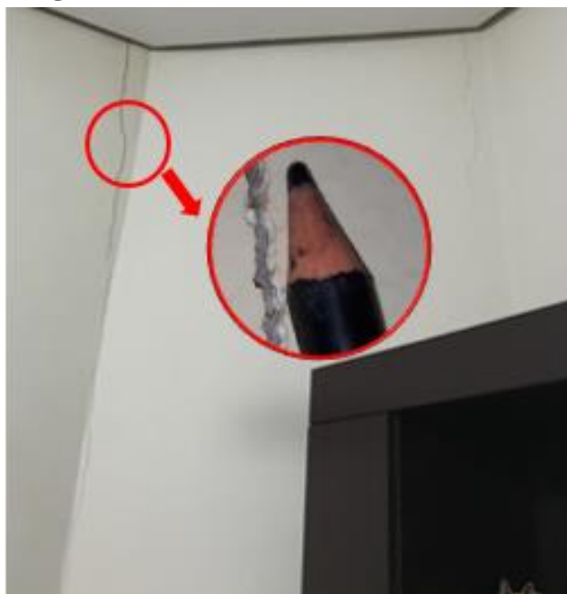
Figura 30. Parede da sala com trinca vertical.
