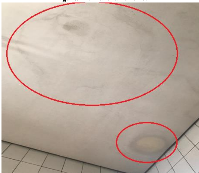
Figura 41. Mancha no forro.
