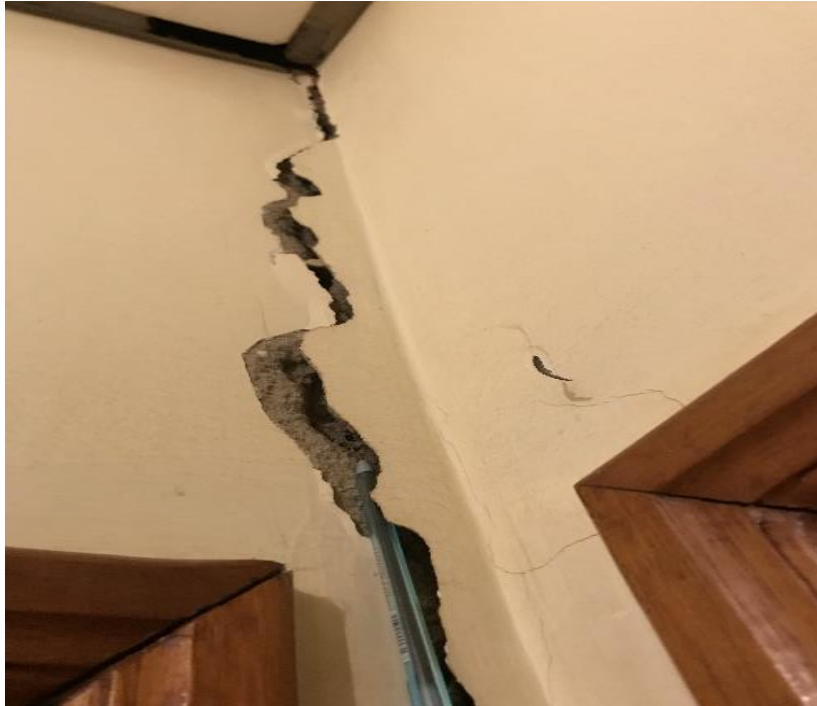
Figura 27. Parede do corredor com rachadura vertical.
