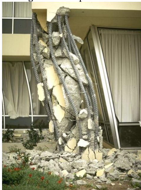
Figura 3. Colapso de Pilar.
