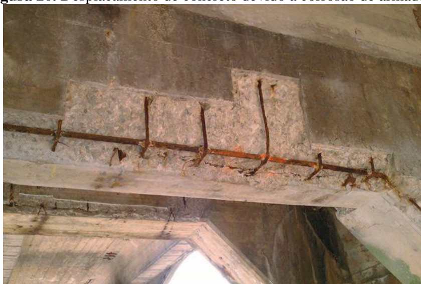
Figura 20. Deslocamento de concreto devido a corrosão de armadura.
