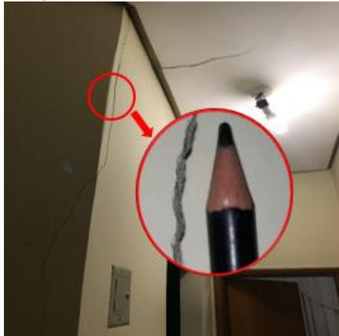
Figura 28. Parede sala com rachadura vertical.
