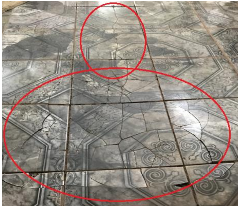
Figura 37. Piso da garagem fragmentado e rebaixado.
