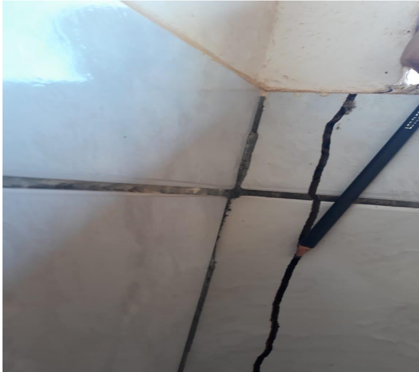
Figura 35. Parede acima tanque da área de serviço com rachadura vertical.
