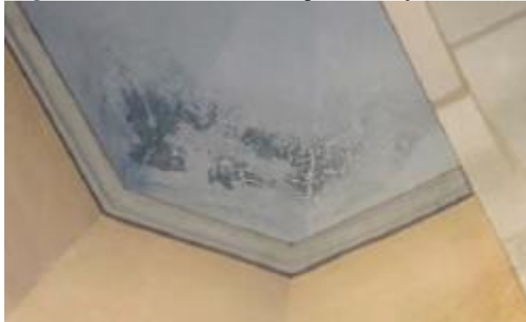
Figura 5. Manchas de umidade por infiltração em forro.
