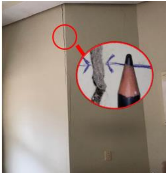
Figura 29. Parede sala com rachadura vertical.
