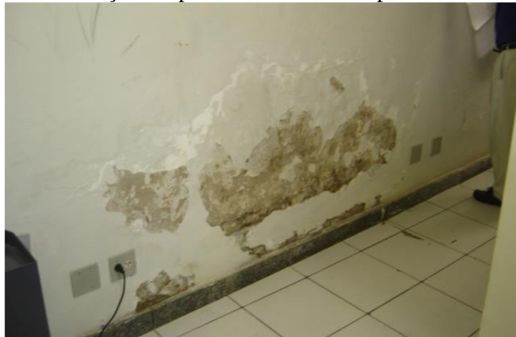
Figura 7. Infiltração em parede devido ao rompimento de tubulação.
