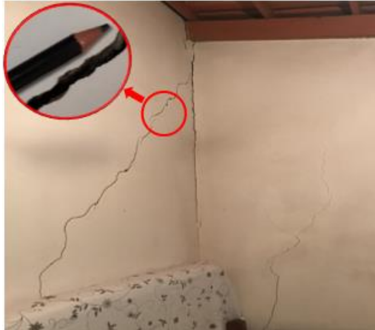
Figura 36. Parede da despensa com rachadura e trinca de 45°.
