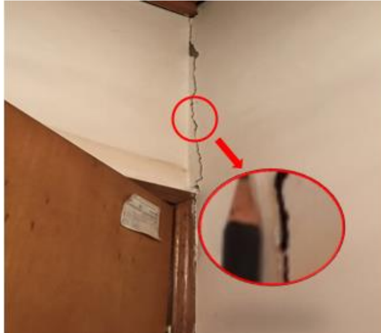
Figura 34. Parede acima da porta da dispensa com rachadura vertical.
