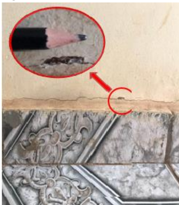
Figura 26. Parede sala com trinca horizontal.
