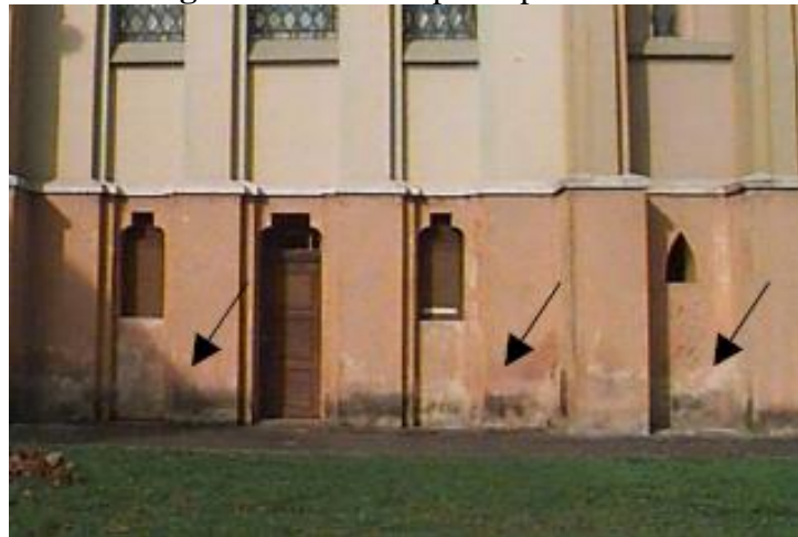
Figura 6. Umidade por capilaridade.
