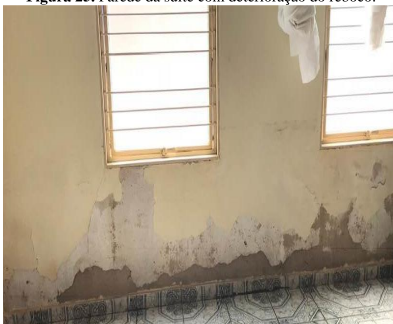
Figura 25. Parede da suíte com deterioração do reboco.
