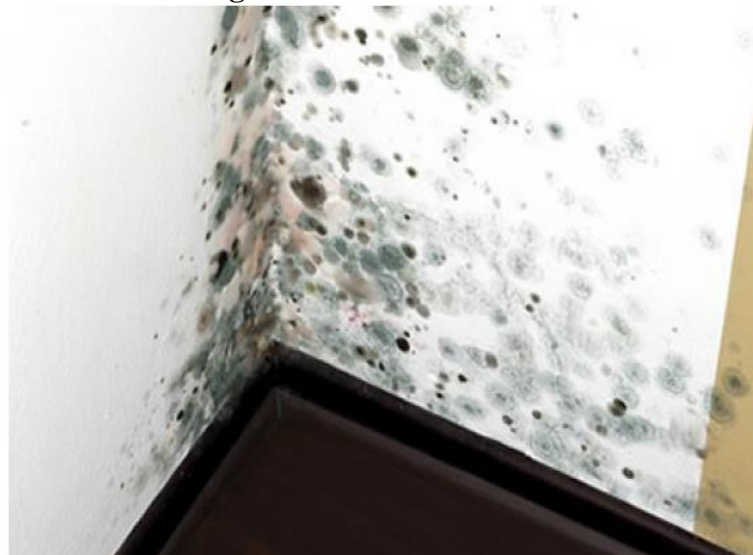
Figura 9. Bolor em fachada.
