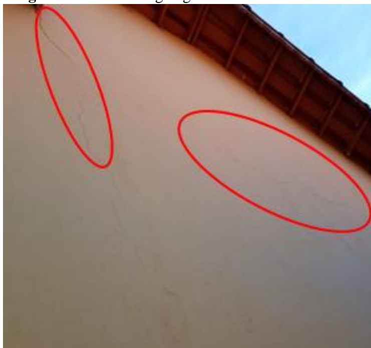
Figura 40. Parede da garagem com rachadura vertical.
