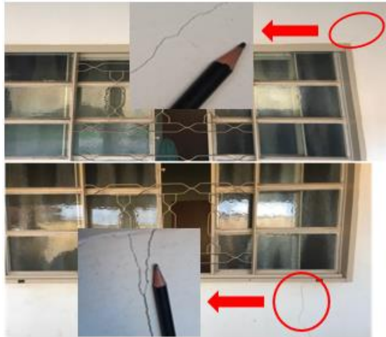
Figura 32. Janelas com trinca vertical e trinca a 45°.
