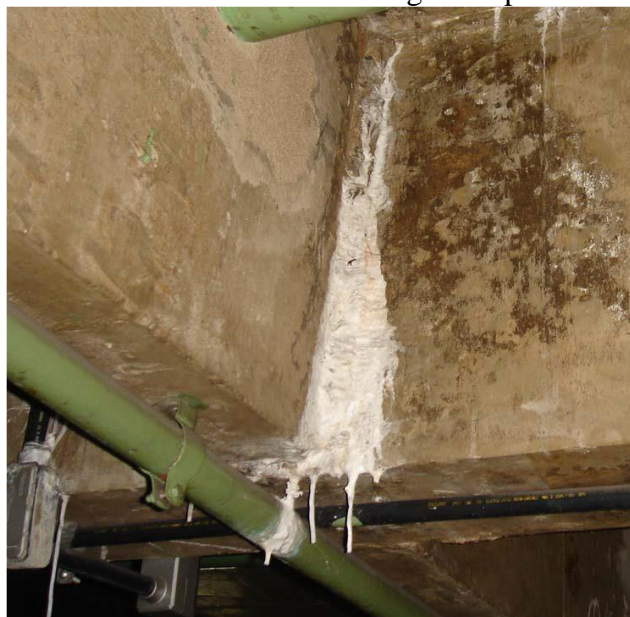
Figura 10. Eflorescência em encontro de vigas em pavimento de garagem.
