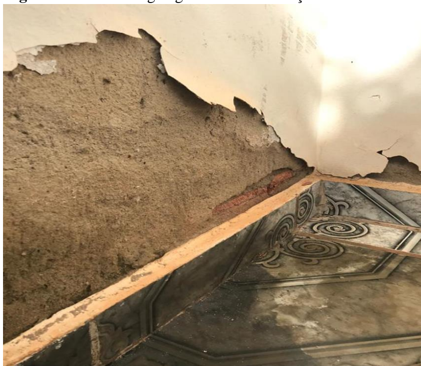
Figura 38. Parede da garagem com deterioração no acabamento.
