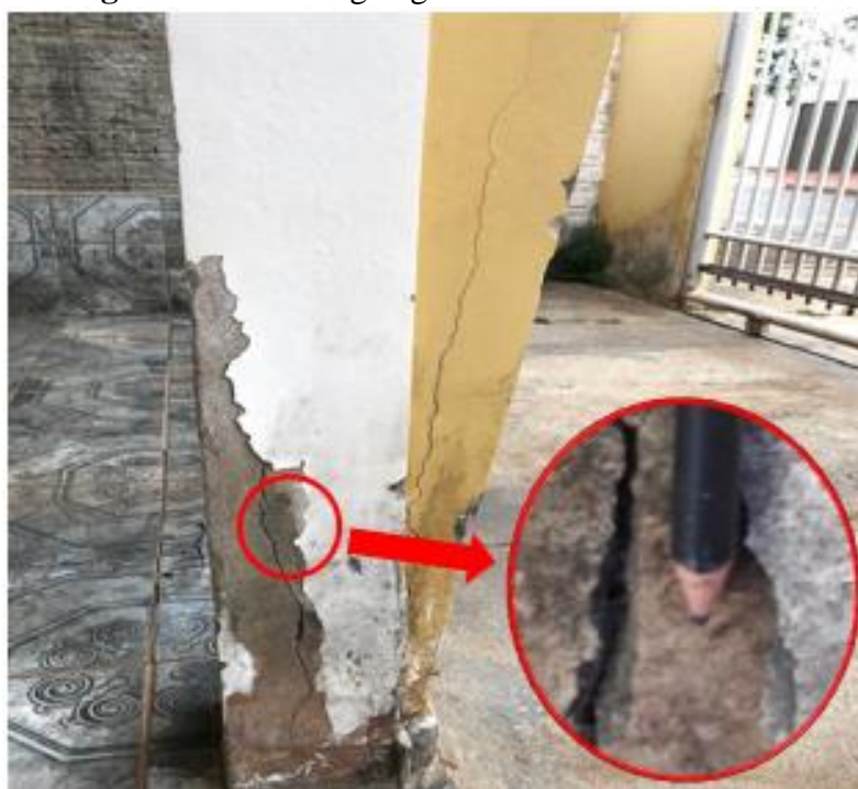
Figura 39. Pilar da garagem com rachadura vertical
