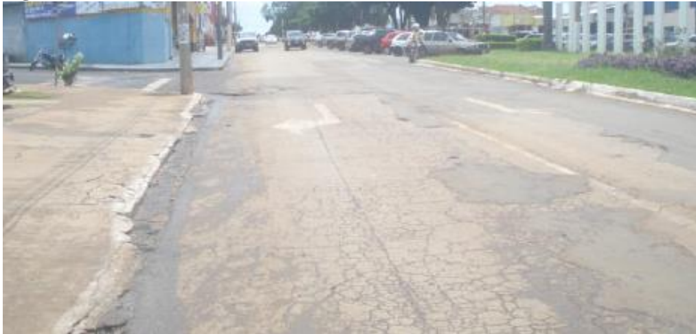
Figura 08 – Trincas no asfalto da Avenida João Belo em Rio Verde/GO.
