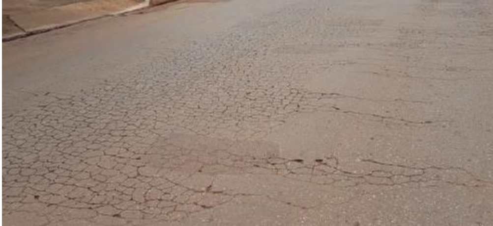
Figura 07 – Trincas no asfalto da Avenida Presidente Vargas em Rio Verde/GO.
