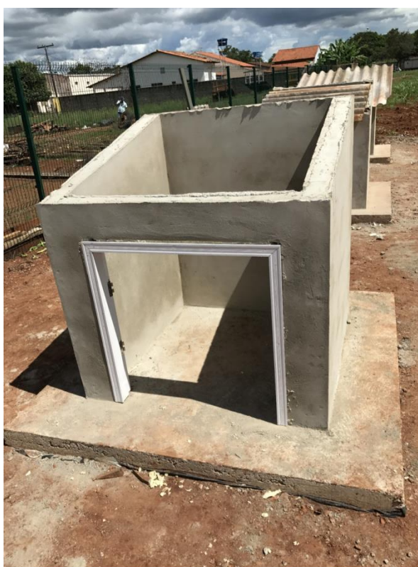
Figura A. 4. Paredes das células testes revestidas com argamassa no traço 1:4 (Fonte: acervo pessoal).
