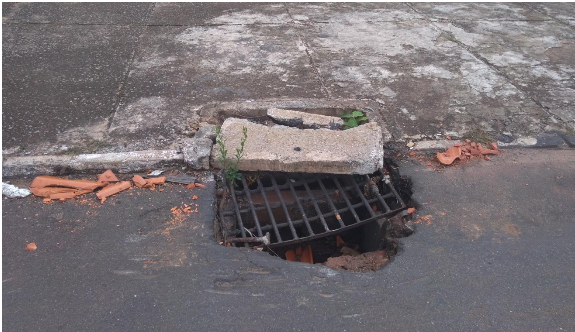
Figura 19 - Boca de Lobo Danificada na Avenida São Francisco
