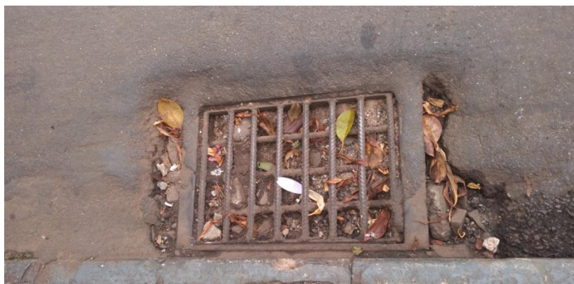
Figura 23 - Boca de Lobo Apresentando Entupimento
