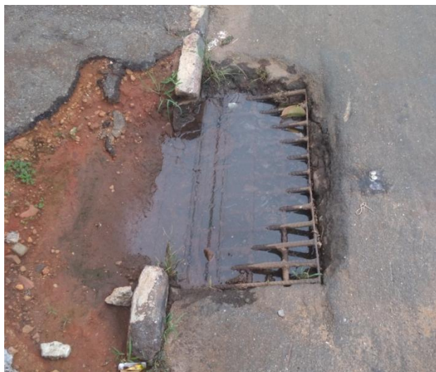
Figura 22 - Boca de Lobo Apresentando Entupimento
