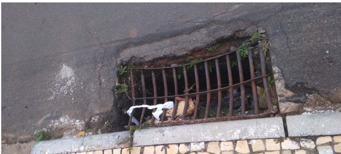
Figura 20 - Boca de Lobo Apresentando Desgaste do Tempo
