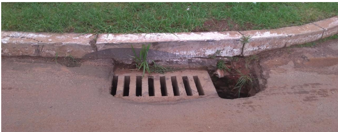
Figura 21 - Boca de Lobo Apresentando Erosão Lateral
