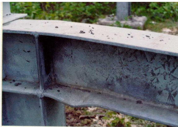
Figura 29 - Flambagem local da mesa
