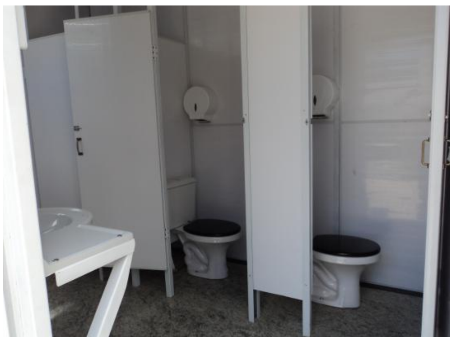
Figura 14: Banheiro unissex para obra
