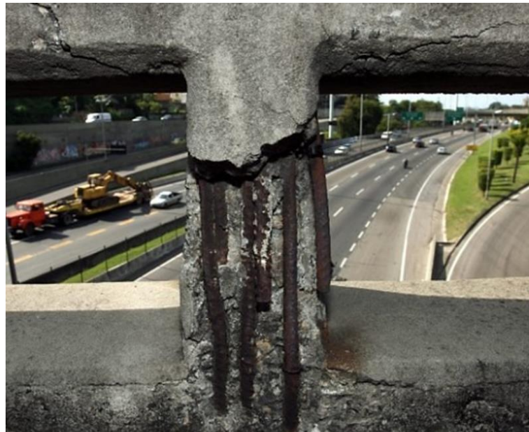
Figura 13 - Pilarete cujo concreto apresenta carbonatação
