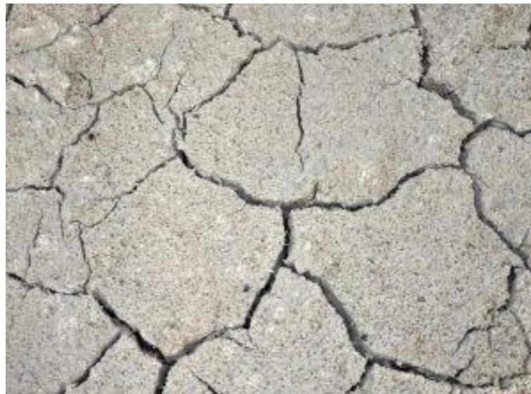
Figura 11 - Fissura em superfície de concreto
